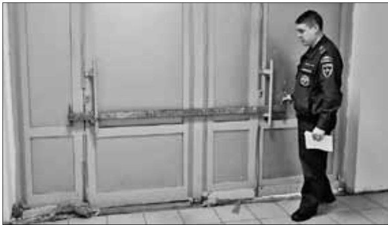
■ Один из эвакуационных выходов ТРЦ «Сафари» закрыт на засов
